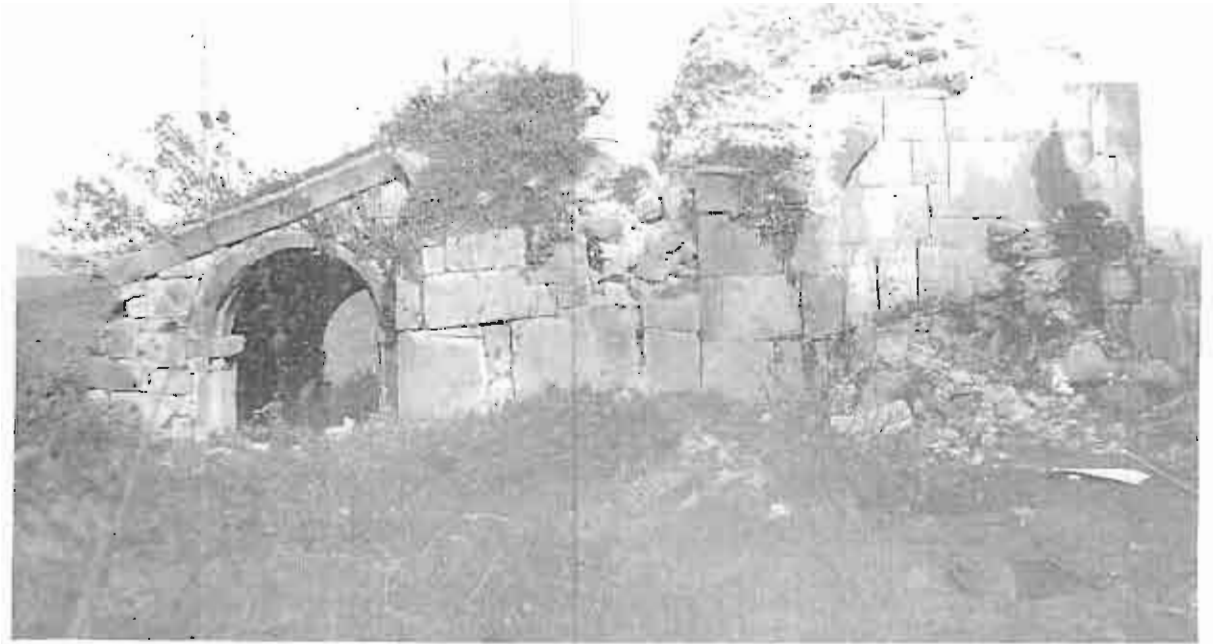
ეკლესიის ხედი სამხრეთიდან. სახურავი აღარ აქვს. ცენტრალურ ნაწილში იგი საერთოდ ჩანგრეულია. დასავლეთ ნაწილში ზედ მცენარეებია ამოსული.
