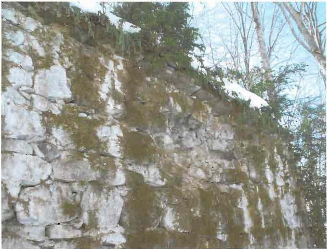
13 დარეა. დაზიანება ჩრდილოეთ ფასადზე
